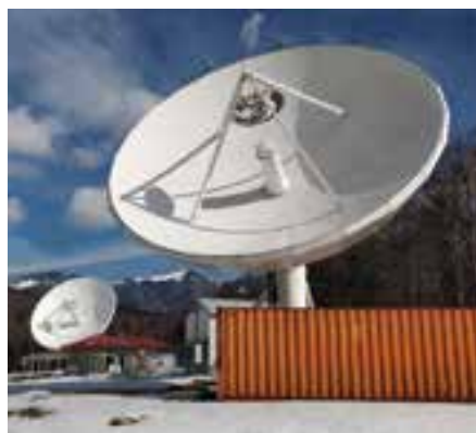
Les antennes de Meteosat Seconde Génération à Cheia, en Roumanie
